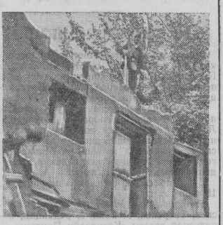
Разрушенный дом в с. Н.-Аклисе.
